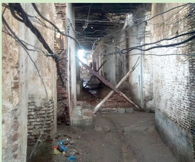
سقف ممر أحد أسواق المدينة القديمة في زيبدة انهار نتيجة الإهمال (إعلام محلي)
