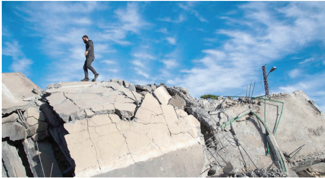
الدمار الذي لحق بمنزل في بلدة كفرحلا بجنوب لبنان بعد قصف إسرائيلي (أ.ف.ب)
