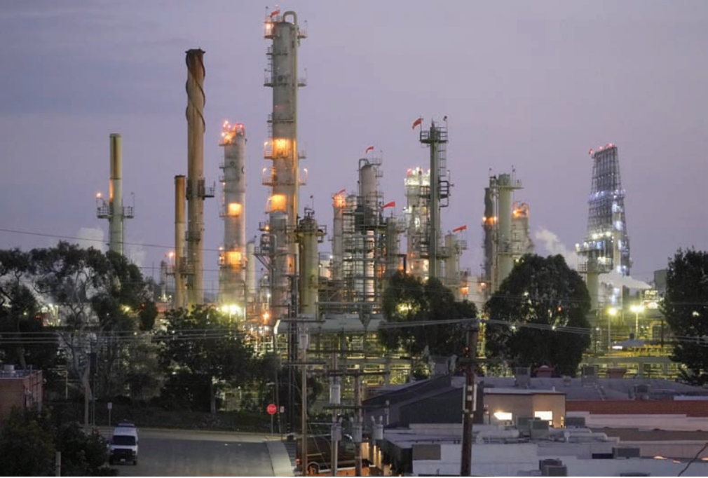
منشآت تكرير نفطية تابعة لشركة «شيفرون» الأميركية العملاقة في ولاية كاليفورنيا (أ.ب.)
