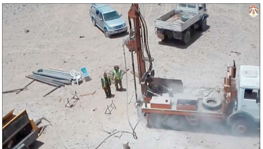
مشروع العناصر الأرضية النادرة في منطقة بديبيد بالأردن (موقع وزارة الطاقة والثروة المعدنية الأردنية)
