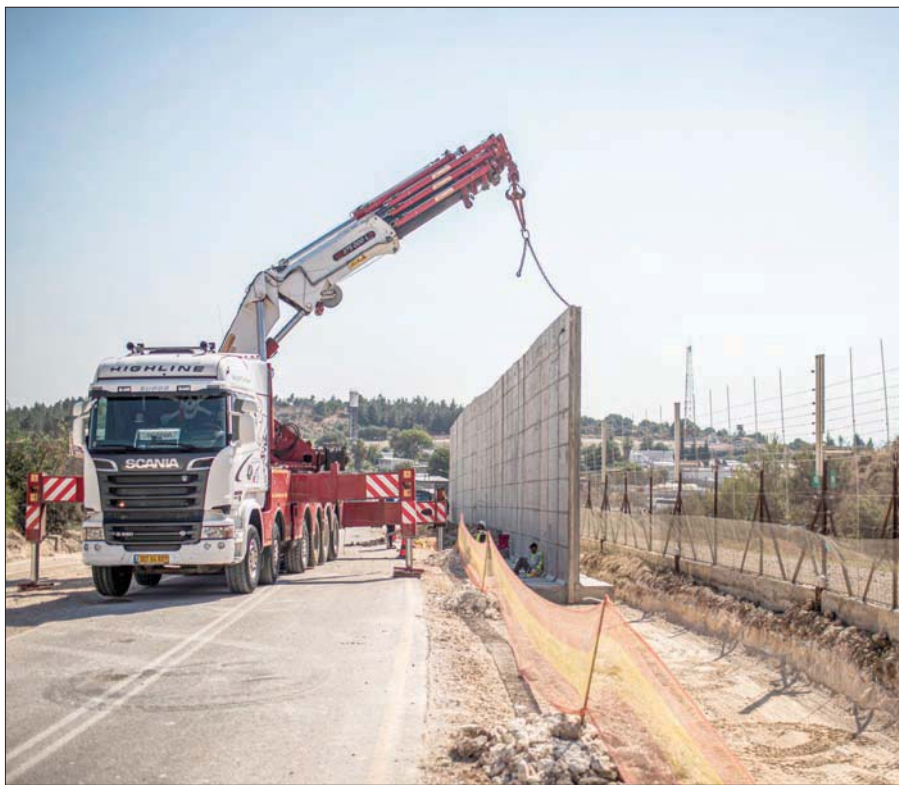
جانب من بناء الجدار الفاصل حول قرية سالم عند الحدود الشمالية لإسرائيل مع الضفة الغربية (د.ب)
