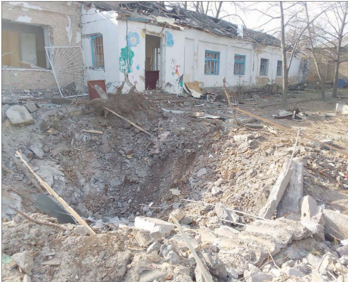
جزء من مبنى مشفى الأطفال بعد تعرضه للقصف في التاسع عشر من الشهر الحالي (الشرق الأوسط)
