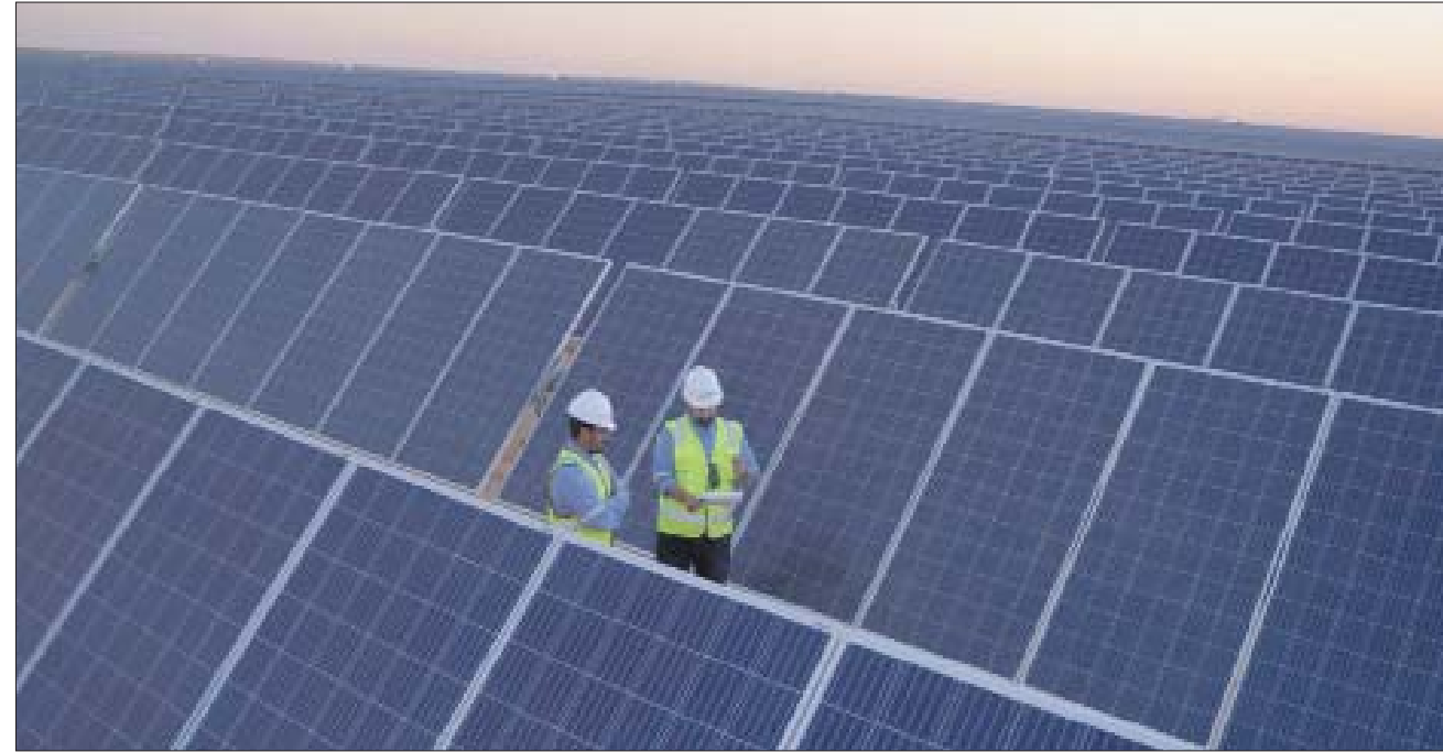
جانب من محطة سكاكا التي تم افتتاحها مؤخراً لإنتاج الكهرباء بالطاقة الشمسية شمال السعودية (الشرق الأوسط)
