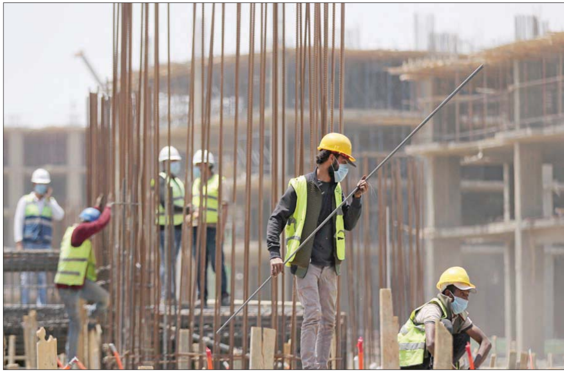
عمال ومهندسون في أحد المواقع الإنشائية بالعاصمة الإدارية الجديدة في مصر (رويترز)
