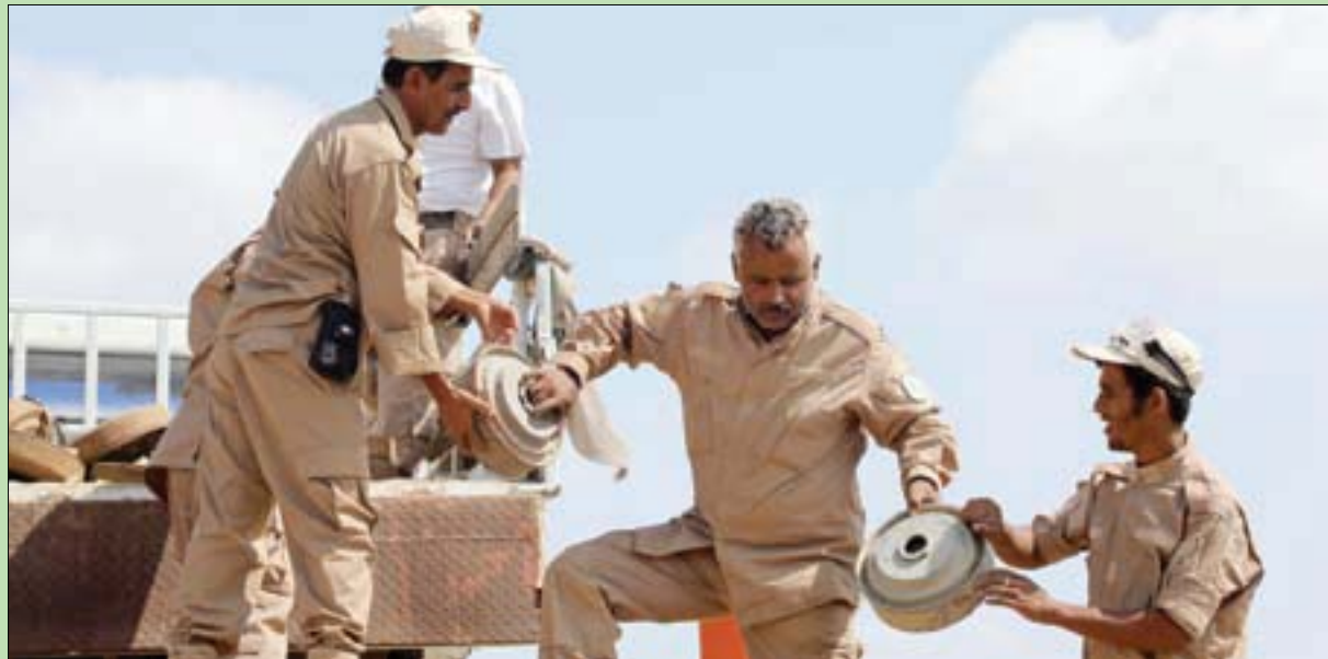
جانب من عمليات نزع الألغام التي زرعها الجوثيون في المخا غرب اليمن (إ.ب.)
