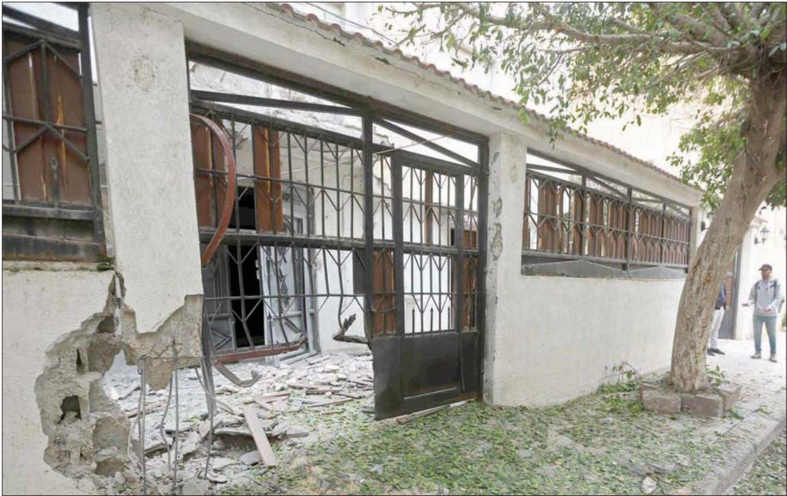
منزل تعرض للكصف في منطقة بطاطا بالعاصمة الليبية بعد تجدد المعارك أمس (أ.ب)
