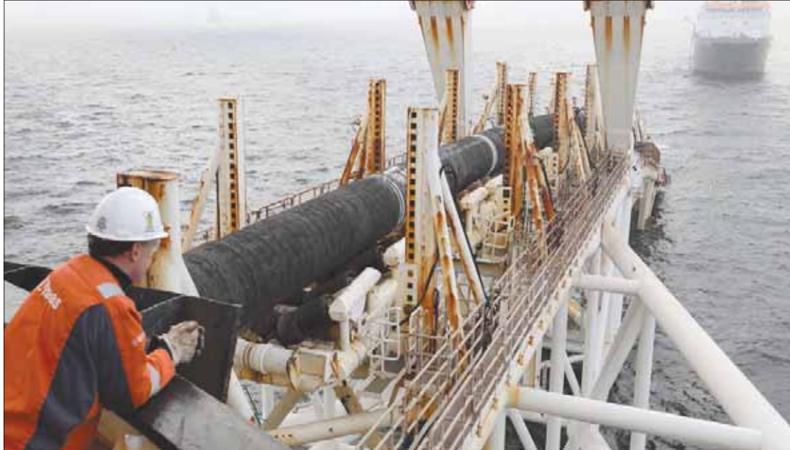
عامل على متن سفينة تضع أجزاء من خط أنابيب «نورد ستريم 2» في بحر البلطيق قبالة ساحل شمال شرقي ألمانيا (أفب)
