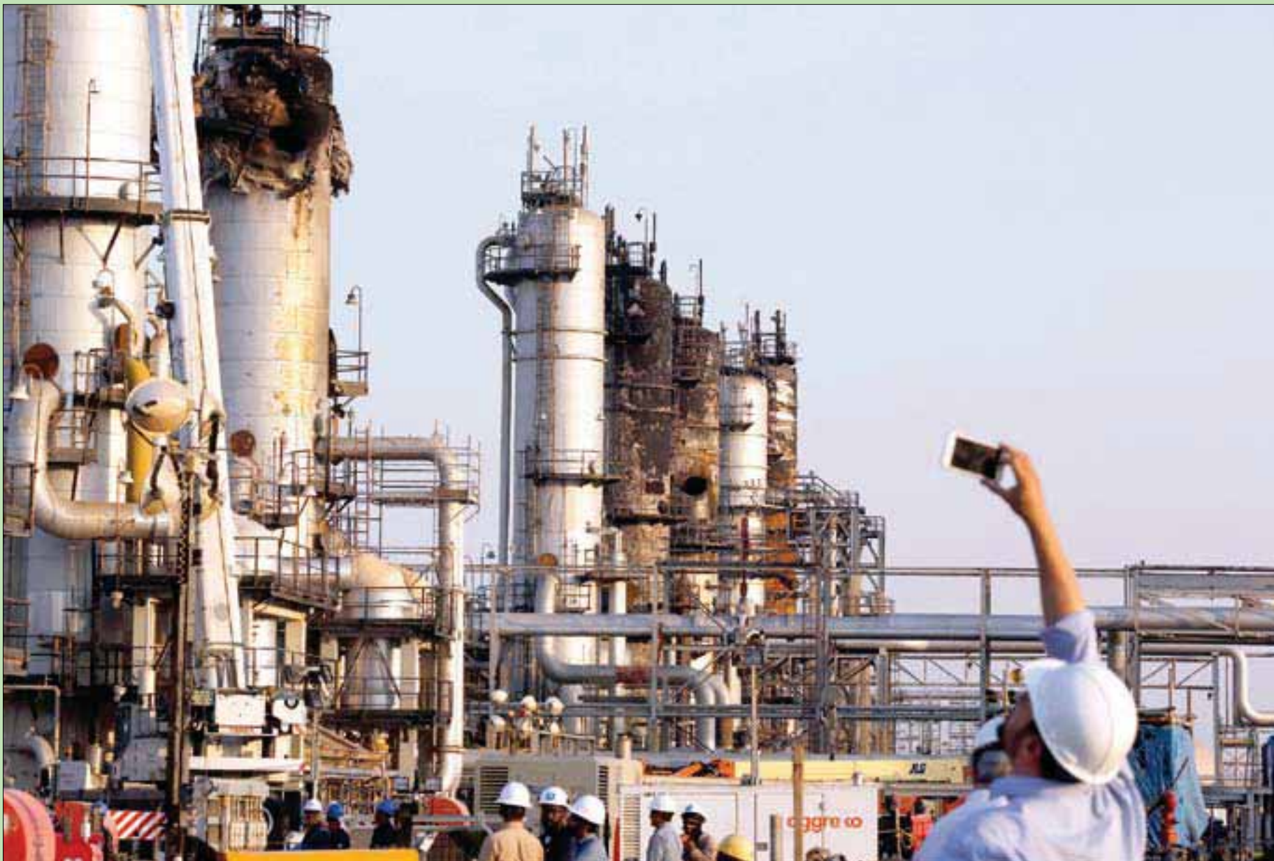
أحد الصحفيين يلتقط صورة لأضرار لحقت بمعمل بقيق التابع لشركة أرامكو السعودية (أ.ب)
