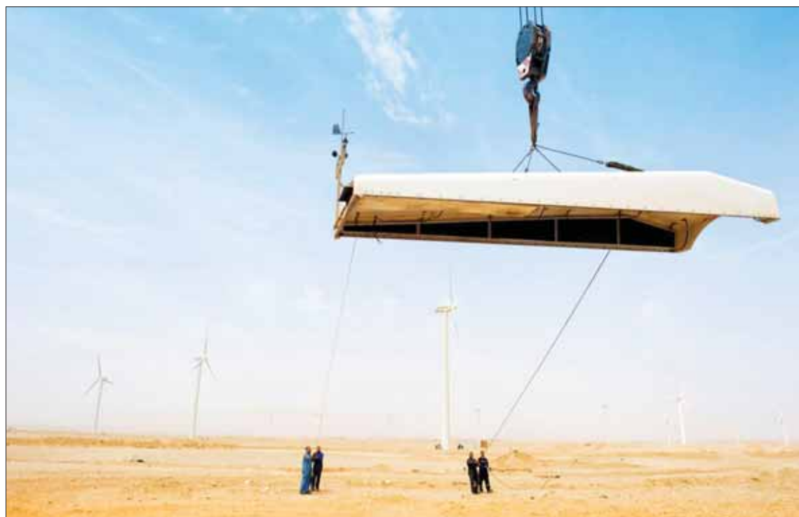
محطة توليد الكهرباء في الزعفرانة
