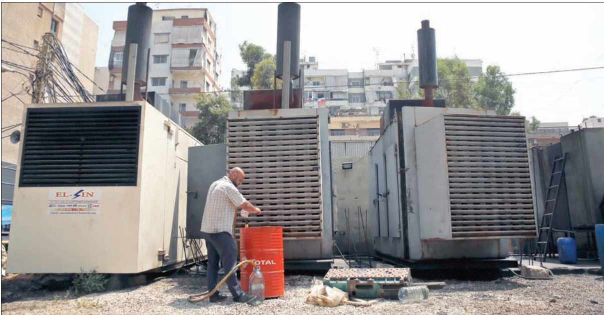
مواطن لبناني يشغل مولدة خاصة تمد مستهلكين جنوب بيروت بالكهرباء (أ.ب)
